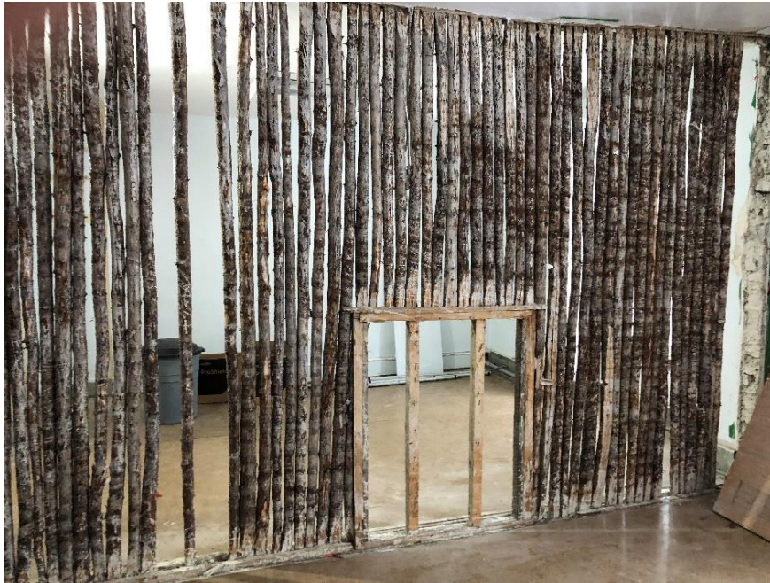
Cloison de grumes avec une ouverture qui aurait permis la circulation de la chaleur entre les pièces. Monastère de l'Hôpital général de Québec. Photo : Mélanie Tremblay, 2022
