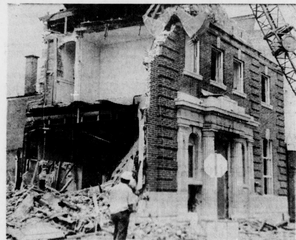
L'édifice de la banque Provinciale du Canada n'est plus. Dans quelques semaines, il sera remplacé par un nouvel édifice de construction moderne. La démolition est terminée depuis quelques jours. (Photo Yves Champoux)
