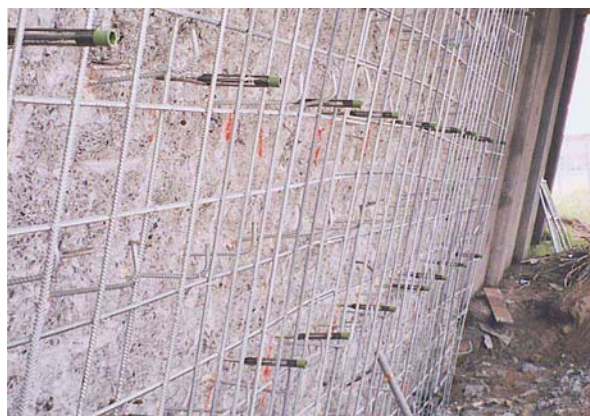
5. Ancrages utilisés en combinaison avec tirants pour travaux d'entretien
