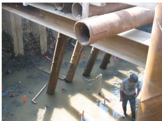
5. Fond d'excavation détrempe : nécessité d'un coussin de propreté
