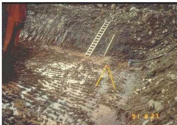
4. Fond d'excavation détrempe à assécher
