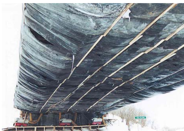
41. Protection type 3 – poutres dans l'abri et unités de chauffage hors abri
