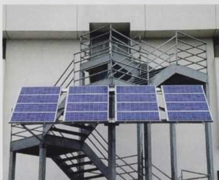
Capteurs solaires joutés à l'éolienne
