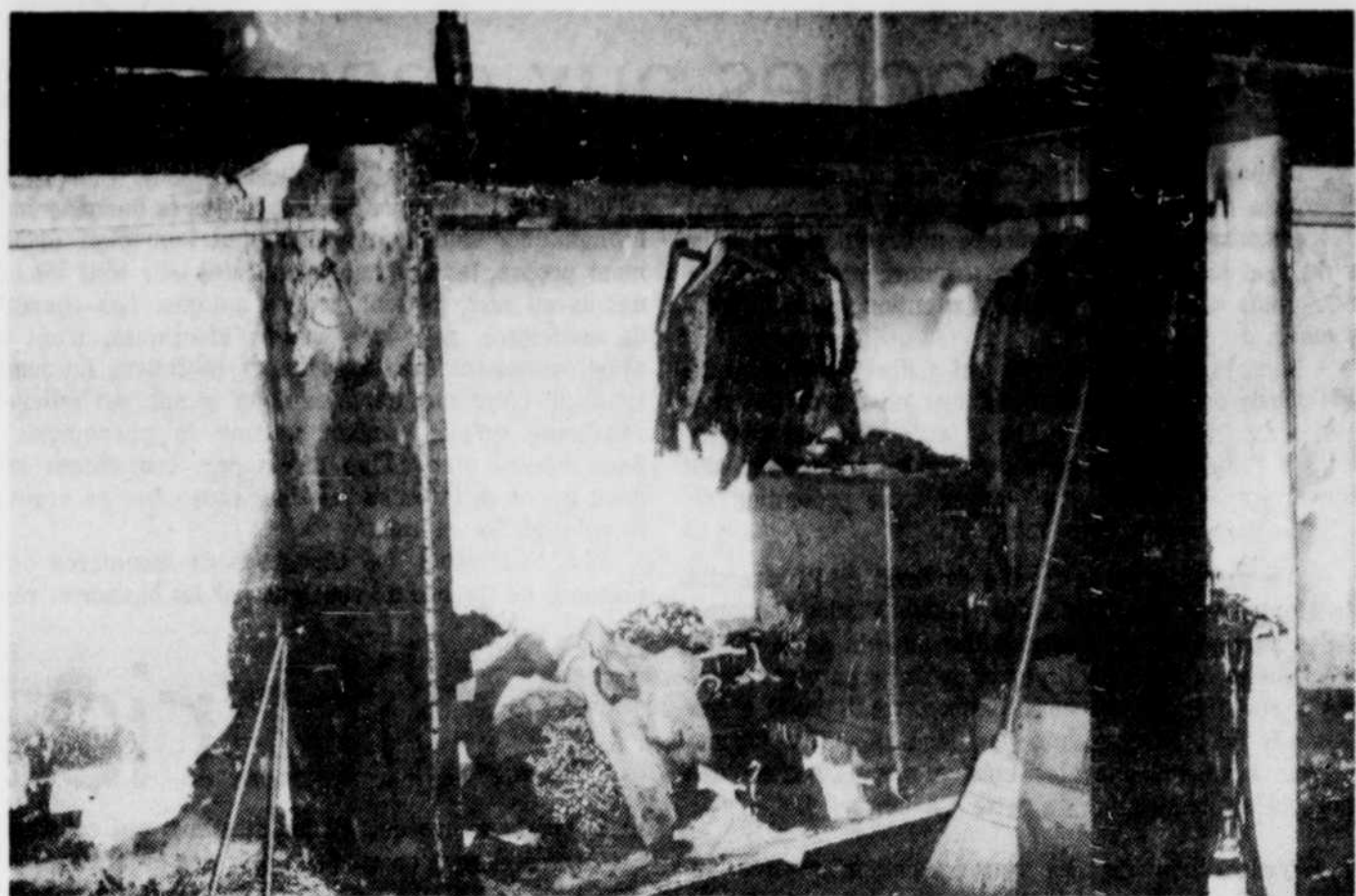
INCENDIE — Un mégot de cigarette serait à l'origine de cet incendie qui a détruit une partie de l'intérieur de la Mercerie Moderne située au 135 Hériot. Les dommages ont été sommairement évalués à $8.000. On peut voir sur la vignette l'endroit où a débuté l'incendie. (Photo La Tribune, Drummondville)
