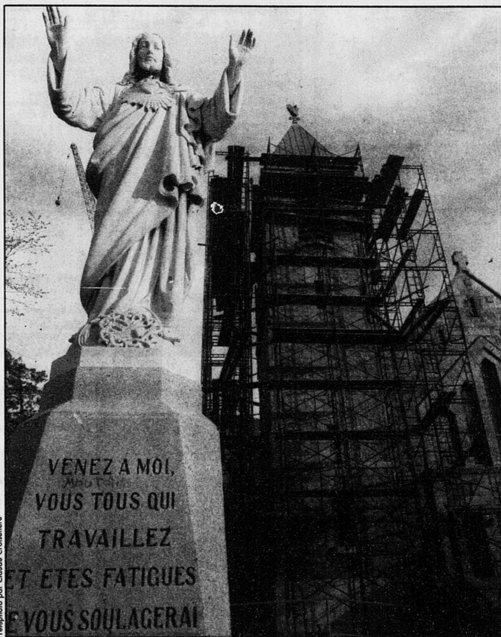
Les travailleurs sont juchés sur les échafauds à l'extérieur de l'église Sainte-Jeanne-d'Arc de Sherbrooke, afin de réparer un clocher qui menaçait de s'affaisser.
