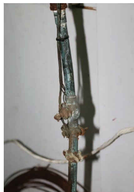
La mise à la terre branchée à l'entrée d'eau en 1984 était la source du problème. Celle-ci a été coupée et remplacée.
