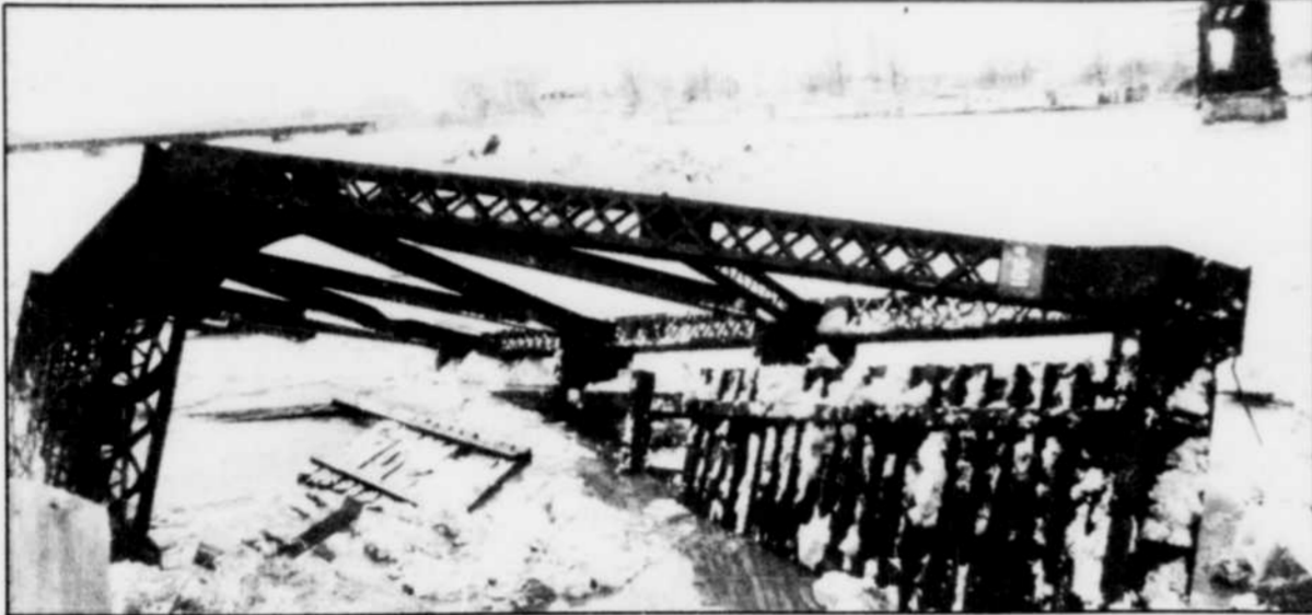
La structure du pont de Sainte-Anne-de-la-Pérade est encore sur la rivière du même nom, et CP Rail ne sait pas encore quand elle sera récupérée. (Photo Yves Champoux)
