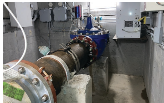
Exemple d'une chambre de régulation de pression : régulateur avec transmetteur de position et pilote électronique, débitmètre, robinet de prise pour vérification, transmetteurs de pression, pompe, chauffage et déshumidificateur.
