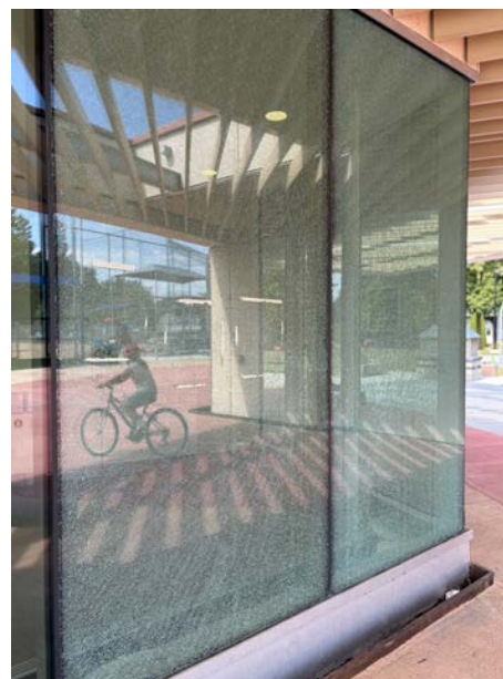
Deux vitrines du chalet du parc Jolliet ont été fracassées. (Photo : Frank Jr Rodi)
