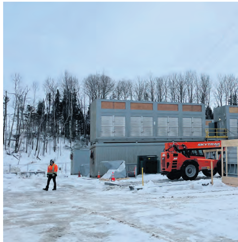
Le centre de données des Escoumins commencera ses opérations à la fin février et
