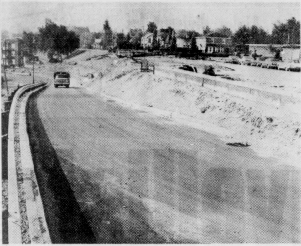
UNE RAMPE D'ACCES, entre la rue et le boulevard Lavolette, est ouverte à la circulation depuis quelques jours. Elle permettra éventuellement aux automobilistes d'atteindre le nouveau pont sur la rivière Saint-Maurice. Cette voie fait partie du carrefour Lavolette-Boulevard Saint-Louis, dont la mise en oeuvre est confiée à Walsh Quebec Construction Ltd. (Photo Roland Lemire)
