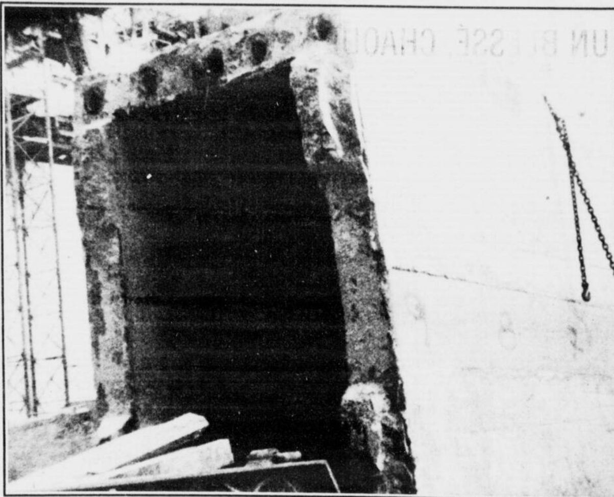
Voici le voussoir qui est tombé d'une hauteur de 185 pieds et qui a entraîné dans la mort quatre ouvriers du local 711. Les ouvriers travaillaient à l'in-
