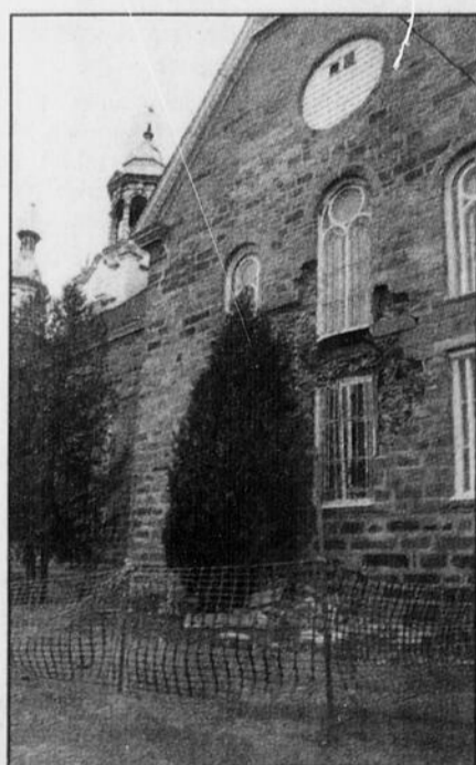
De lourdes pierres se détachent du mur droit de l'église de Saint-Claude. Les réparations coûteraient environ 45 000 $.
