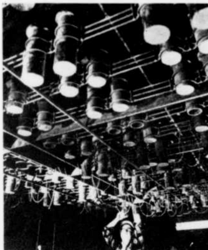
Un technicien fait l'inspection de la section inférieure des plaques auxquelles adhèrent les particules polluantes extraites des gaz d'échappement d'un précipitateur électrostatique.
