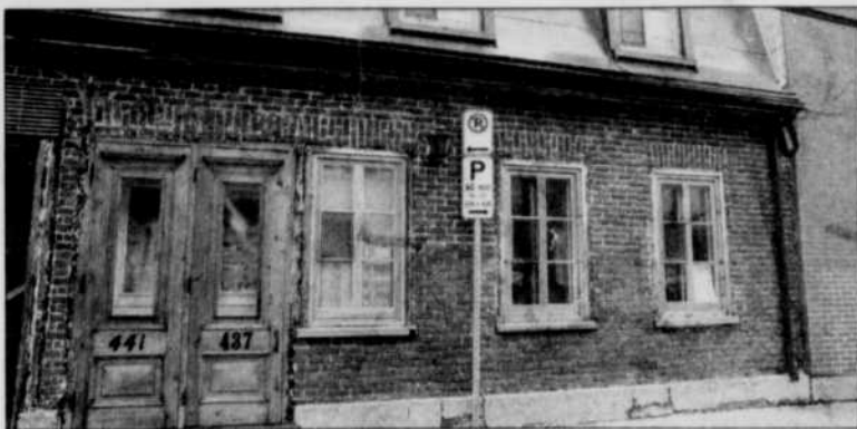
La maison de la rue La Salle visée par l'ordonnance.
