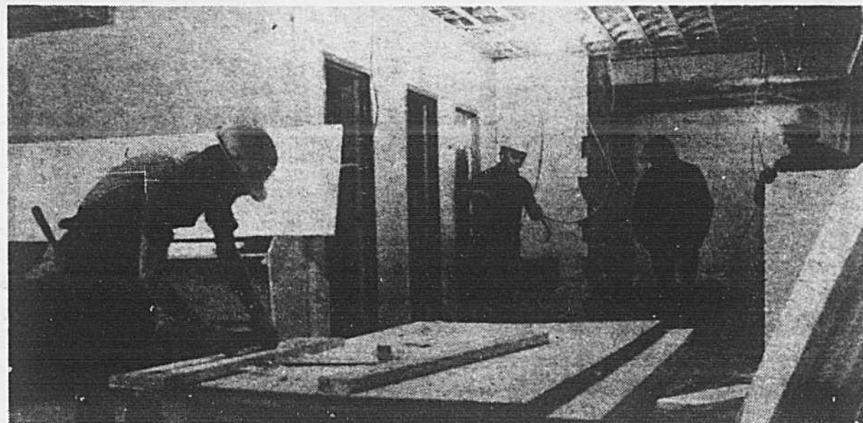
Les employés municipaux sont en train de faire des travaux de rénovation au chalet du parc mais le tout ne sera pas prêt pour le début de mai. Le terrain sera prêt cependant.
