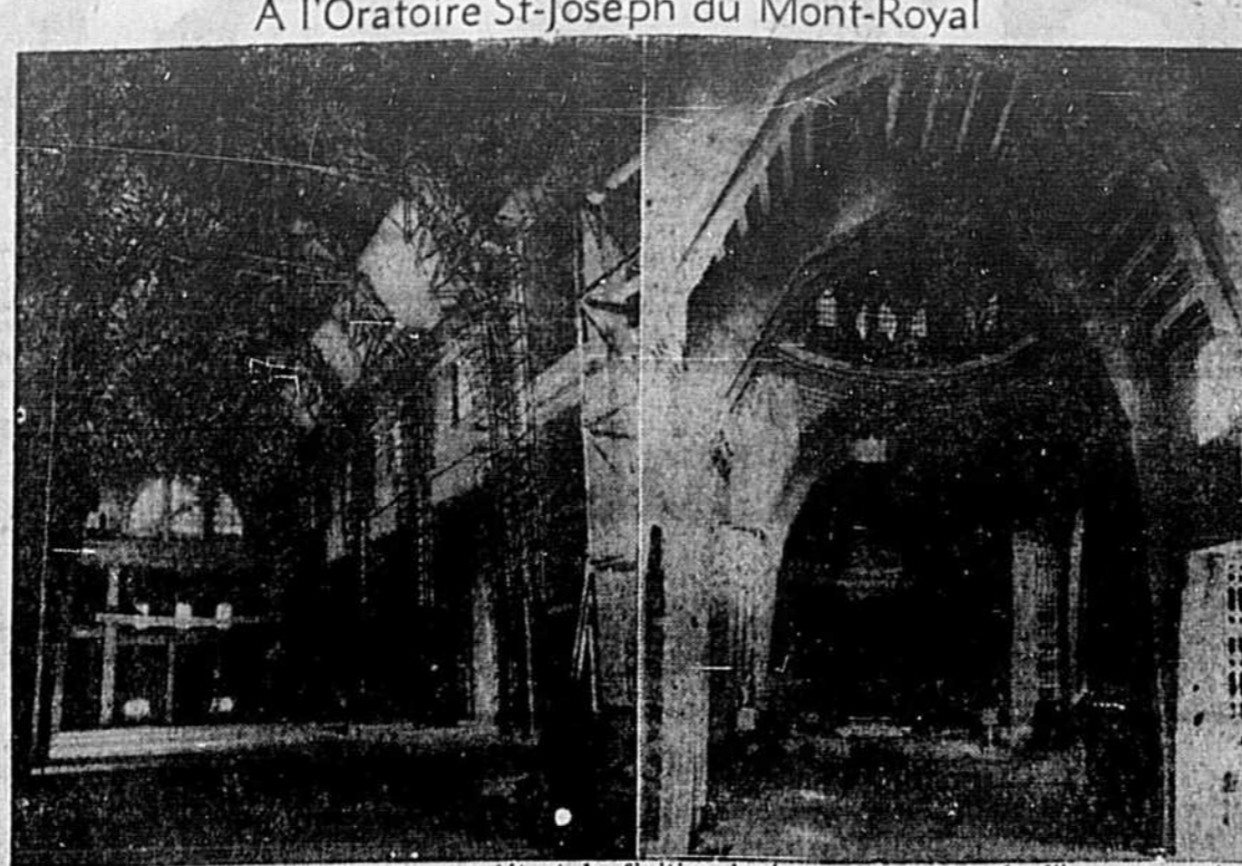
Les travaux de construction dans le vaste basilique de l'Oratoire St-Joseph du Mont-Royal ont connu une impulsion sans précédent au cours des deux dernières années. Les autorités du sanctuaire espèrent terminer cet été la pose des enduits de béton coloré complétant la finition basique des murs intérieurs. Il sera ensuite possible d'ouvrir le temple en permanence au culte. Ci-dessus, on voit l'intérieur de la basilique tel qu'il apparaissait il y a un peu plus d'un an avec son réseau de charpente métallique, à côté d'une vue de l'immense vaisseau prise il y a un mois, alors que la confection des murs était fort avancée. C'est pour finir ces travaux que l'Oratoire a lancé un deuxième appel à ses amis et bienfaiteurs au début de juillet.
