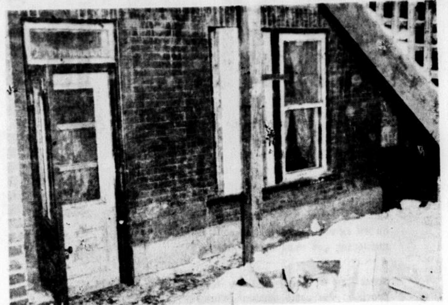
DOUZE ENFANTS VIVENT derrière ces murs, dans trois pièces. Les fenêtres n'ont plus de vitres, la porte ferme difficilement tellement le bois est rongé, enflé, déformé, la brique s'ef-
