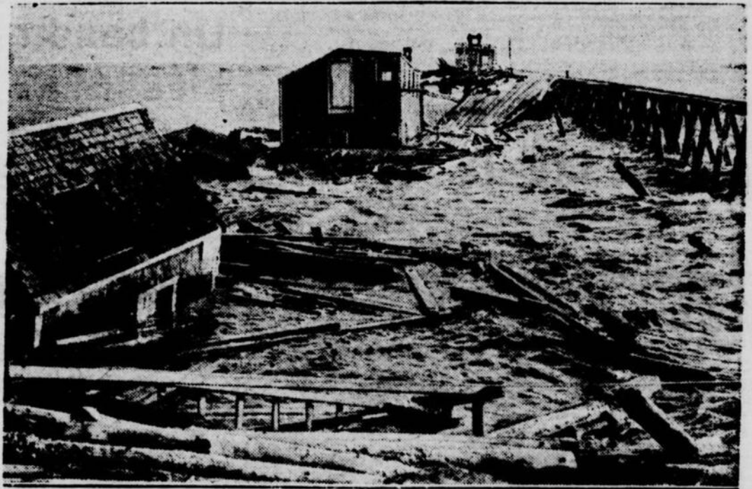
Voici les résultats d'un vent de 70 milles à l'heure qui s'est abattu sur les quais de Provincetown, Mass., à la pointe du cap Cod. L'on voit ici tout ce qui reste d'un immense quai d'entreposage, qui s'écrasa sous la violence de l'ouragan
