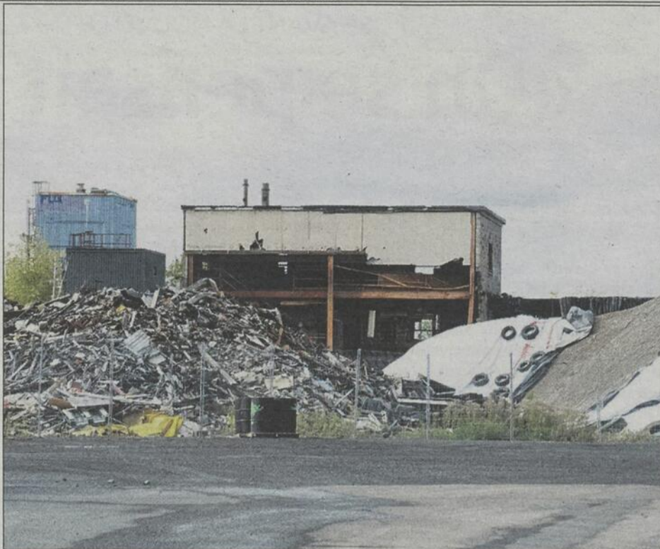
La Ville projette de démolir l'ancienne usine de Pigments et Couleurs International, un site orphelin sur lequel elle a mis la main.
