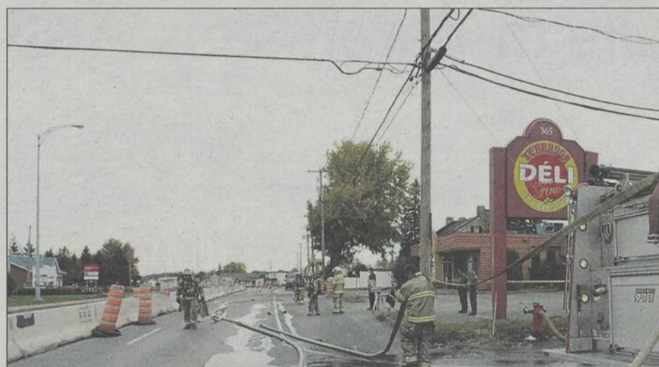
Une deuxième fuite de gaz s'est produite sur le chantier de réfection du boulevard Saint-Luc, mardi après-midi.
