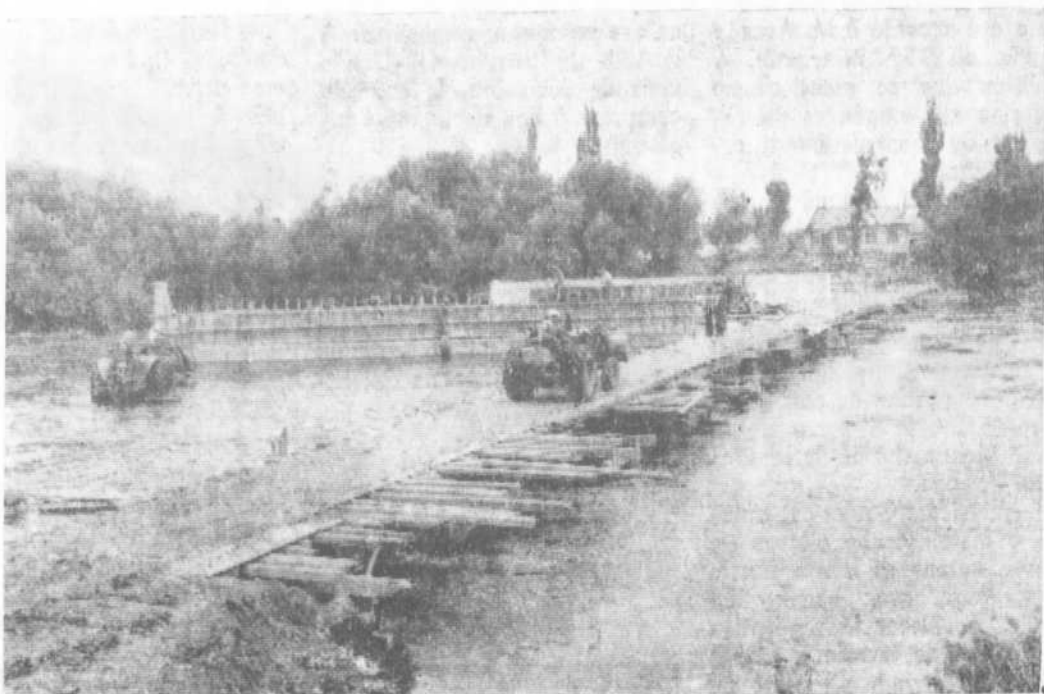
Les travaux du pont photographiés ces jours derniers de l'île St-Jean, vis-à-vis Terrebonne. L'entrepreneur coule actuellement les piliés.
