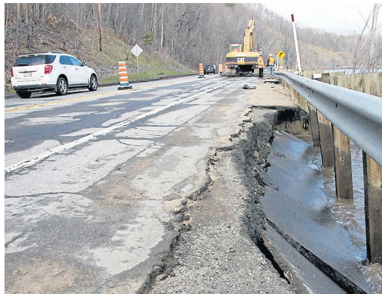
Une partie de la route 153 dans le secteur de Baie-de-Shawinigan a subi des dommages. — PHOTO: SYLVAIN MAYER
