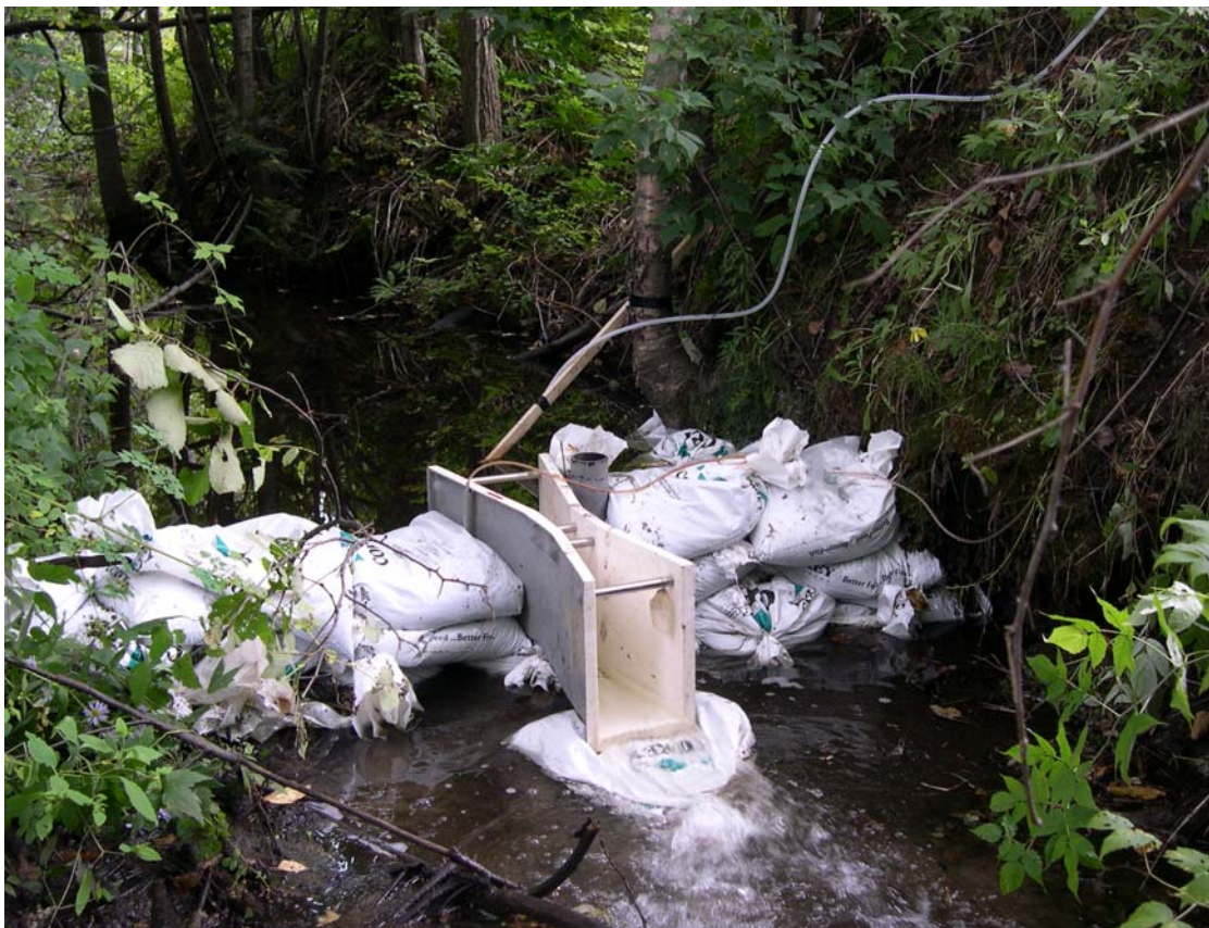
Canal Parshall avec débitmètre bulleur (Installation temporaire – pisciculture)
