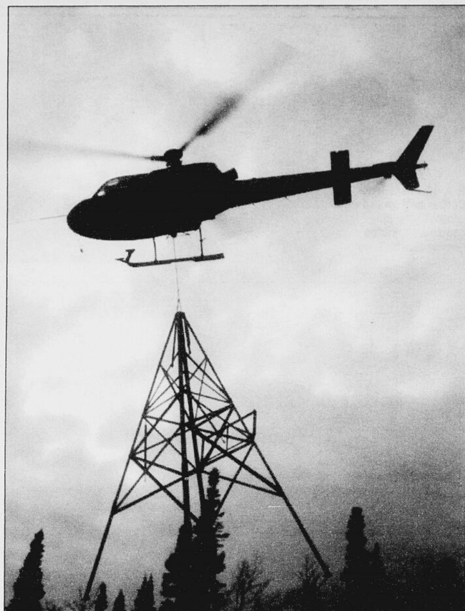
Transport d'une structure par hélicoptère (Astar B2) pour site non accessible, un projet de télécommunication Hydro-Québec.
