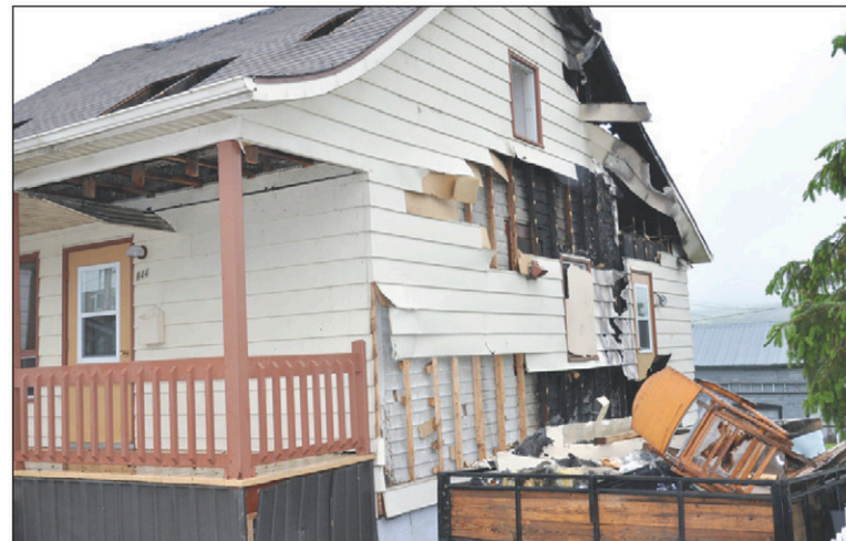
Cette résidence de l'avenue du Moulin a subi des dommages d'environ 50 000 $ à la suite d'un incendie qui a éclaté le 4 juin dernier.
