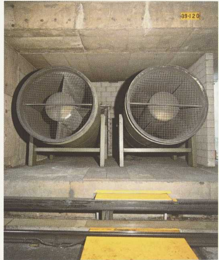
Puits de ventilation en tunnel. (Archives de la STM)
