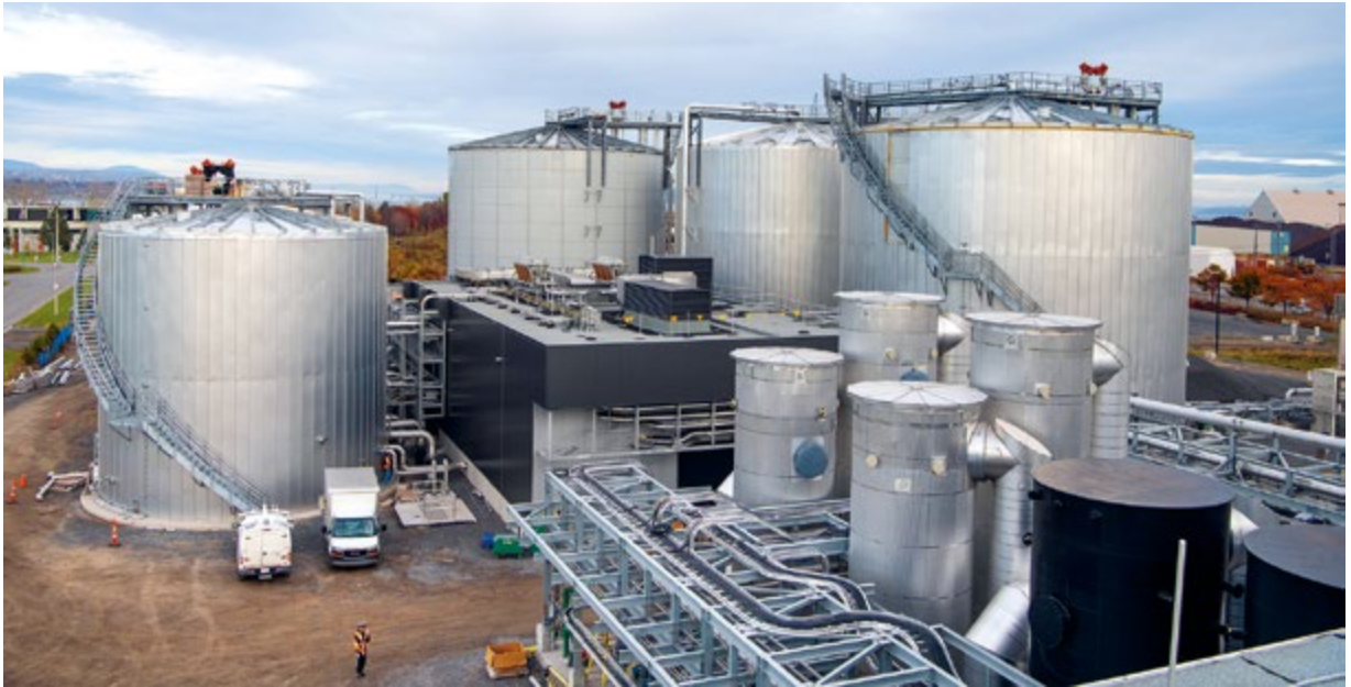
Vue de l'hydrolyseur et des digesteurs du centre de biométhanisation de la matière organique qui transforme en gaz naturel renouvelable et en fertilisants les boues municipales ainsi que la biopulpe.
