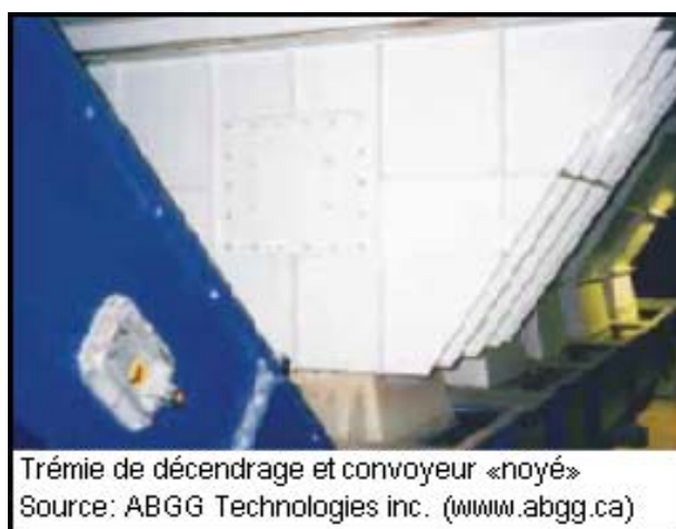
Photo 25 : Trémie de décendrage et convoyeur immergé
