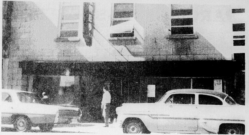
Voici la façade du magasin telle qu'elle apparaissait avant les réparations de 1962.
