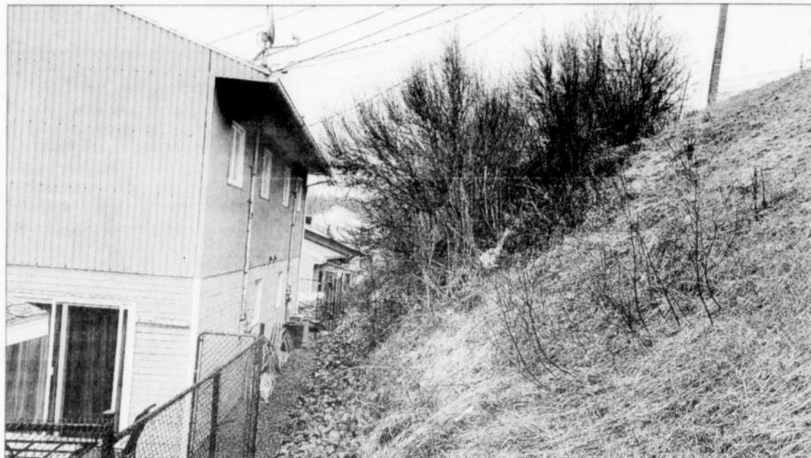
L'habitation a été construite tout près de la falaise qui menace aujourd'hui ses résidents.
