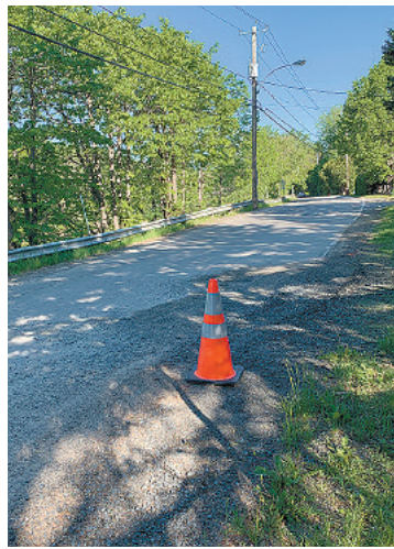
Un «troulaiffissement» qui est apparu à l'automne chemin de la Rivière toujours pas réparé. Depuis avril, lors des inondations la chaussée, chemin de la Rivière, s'est affaissée et le passage des véhicules réduit à une voie.
