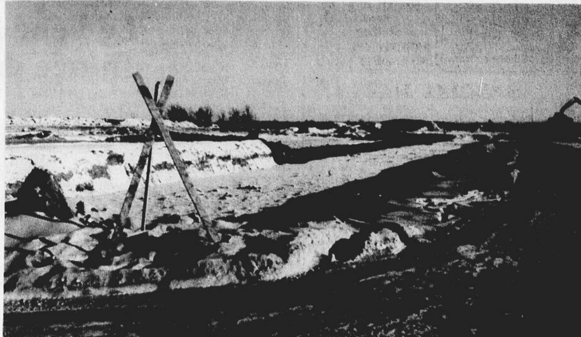
Les travaux d'aménagement des bassins en vue de l'assainissement des eaux usées pour la Ville de Huntingdon vont bon train, et le tout conforme à l'échéancier prévu.
