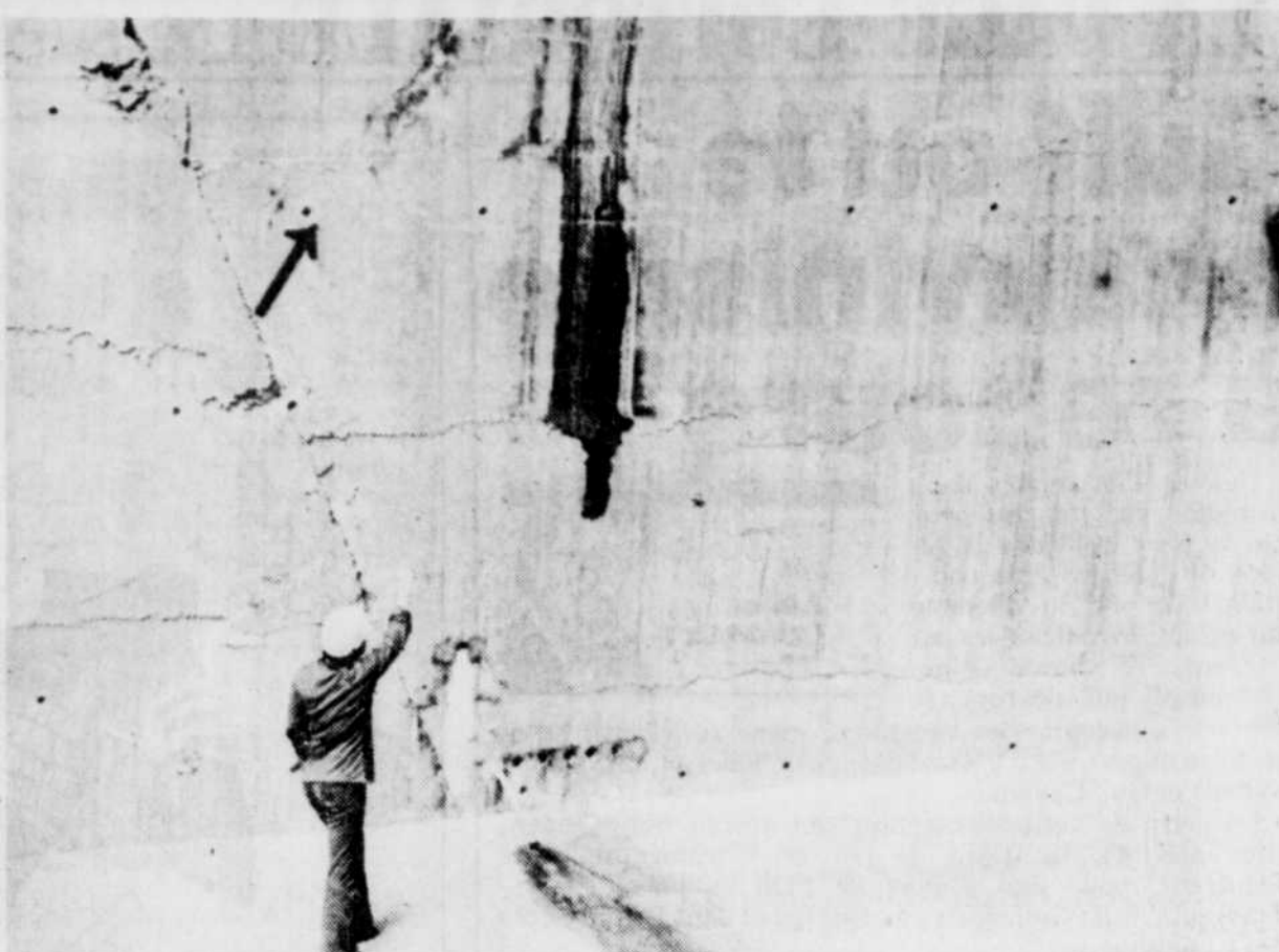
Déjà, en 1974, LE SOLEIL publiait cette photographie montrant les fissures causées par l'eau et le gel au barrage Daniel-Johnson. La flèche indique le sens de l'une d'entre elles.
