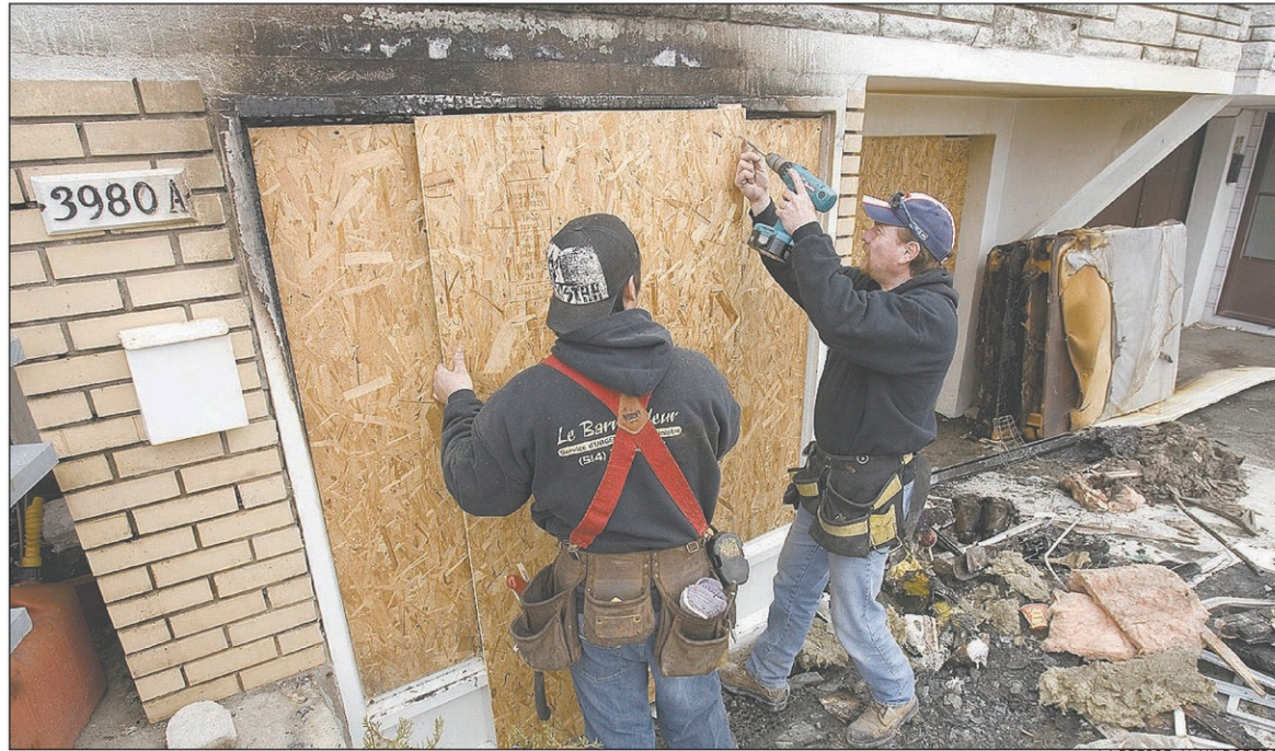
Des ouvriers barricadent l'immeuble où a eu lieu l'incendie qui a coûté la vie à un garçon de neuf ans dans un appartement de l'arrondissement Montréal-Nord, en début de nuit hier.
