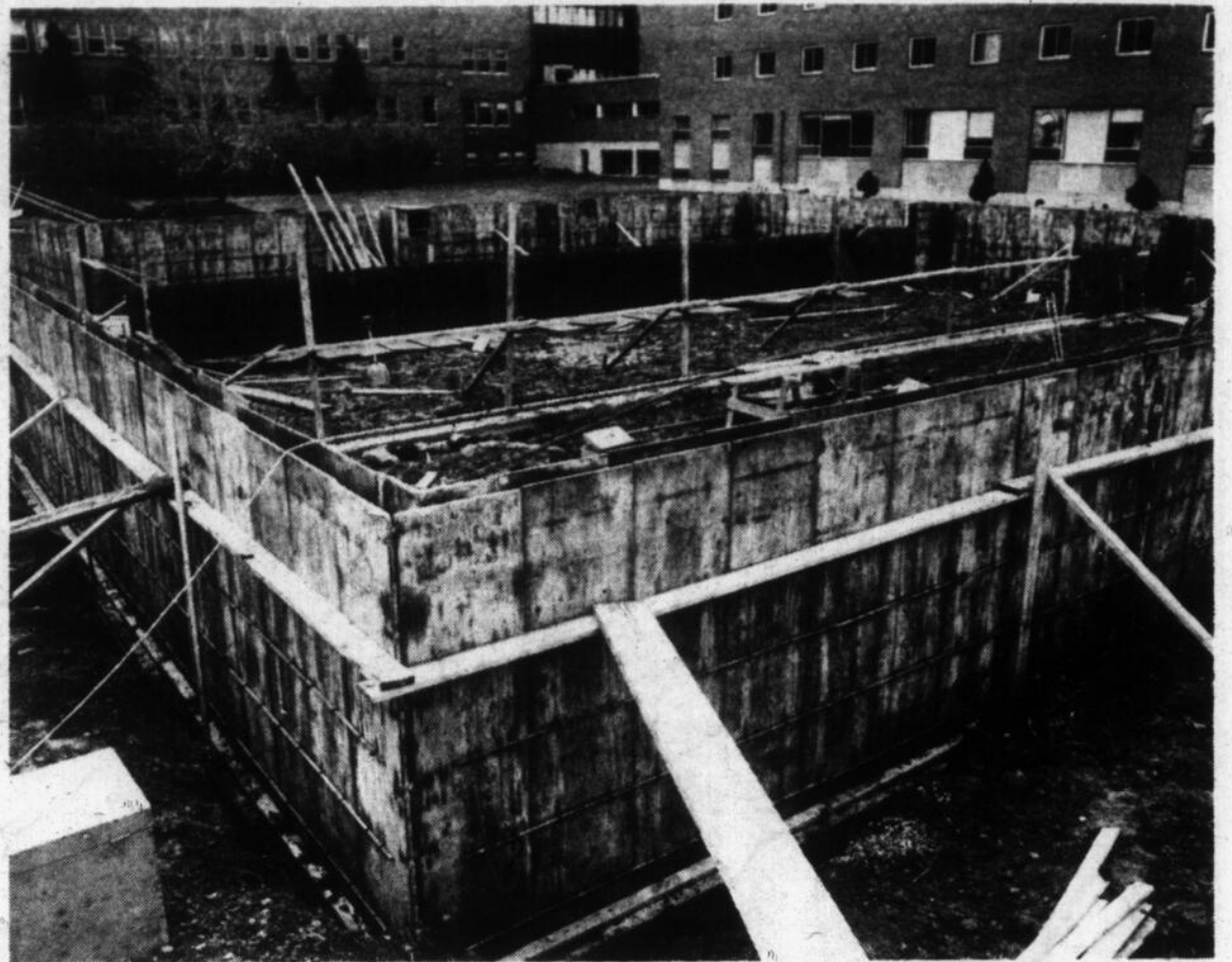
Les travaux de construction de la serre devraient être terminés pour janvier prochain. (Photo François Mélillo)
