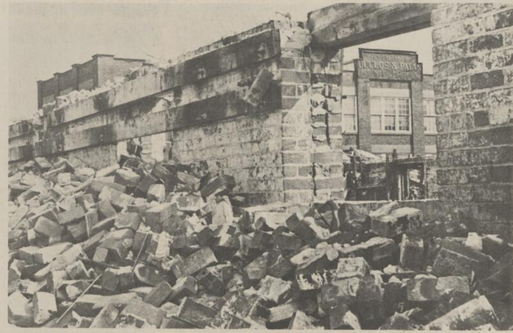
DEMOLITION—L'usine Duclos et Payan, l'une des plus anciennes compagnies de Saint-Hyacinthe ne sera bientôt plus qu'un souvenir. Les démolisseurs s'occupent déjà depuis plusieurs mois à démolir ses murs. La compagnie a été fondée en 1873.
