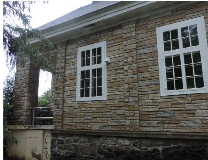
56 (à gauche) Val-Morin. Église Saint-Norbert. Le long pan avec ses fenêtres et fausses arcades (photo Lisa Crouzet)
