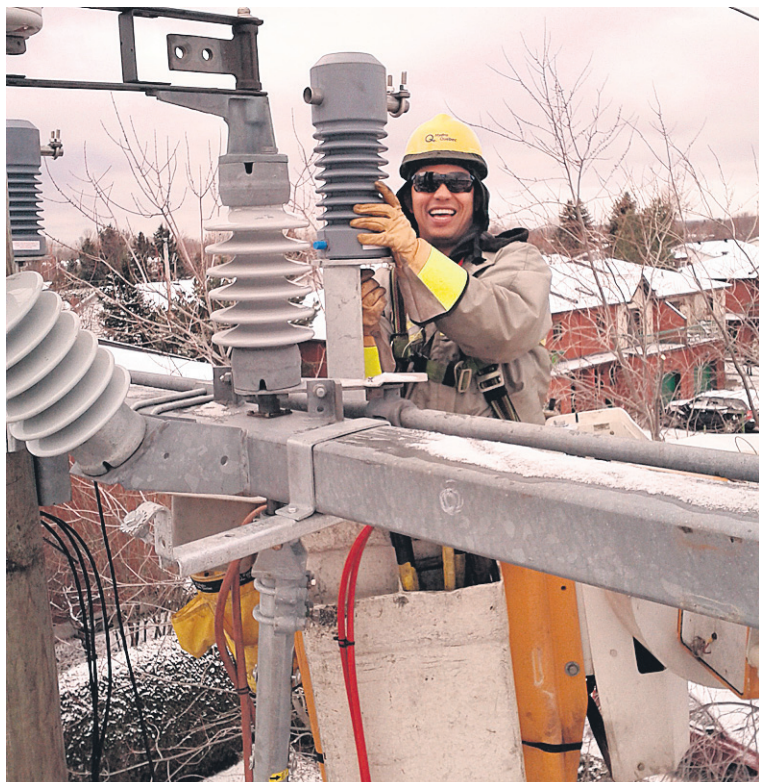
PHOTO FOURNIE PAR HYDRO-QUÉBEC
