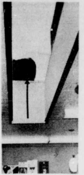
(Photo: Roland Lemire) CE PUITS DE LUMIÈRE A FACILITÉ L'INTRUSION des voleurs dans la Pharmacie Barel. Dans cet établissement, il y avait $4,000 et ils sont disparus. Sur la photo, une flèche indique l'endroit où les voleurs ont pratiqué une ouverture.
