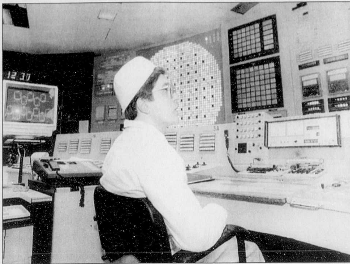
Un ingénieur travaille dans la chambre de contrôle à la centrale nucléaire.
