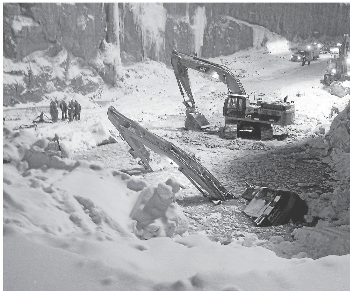
Le chantier hydroélectrique de La Romaine sur la Côte-Nord affiche le plus sombre bilan des 20 dernières années avec quatre accidents mortels depuis le début des travaux, en 2009. — PHOTO FOURNIE PAR LA CNESST
