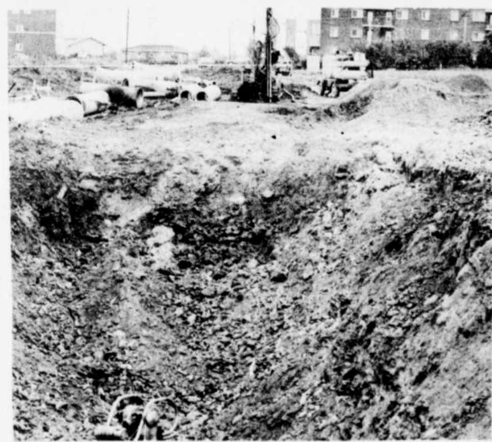
Les travaux d'aqueduc et d'égouts dans la municipalité de Ste-Victoire ont débuté cette semaine. Ces travaux dureront environ deux mois et ils sont évalués à plus de $700,000.
