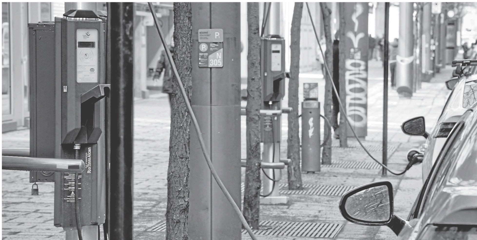
Hydro-Québec aura complété l'installation d'environ 2500 bornes de recharge d'ici 2020. — PHOTOTHÈQUE LE SOLEIL
