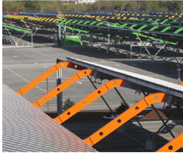
Image 19 : Ombrières de panneaux solaires
