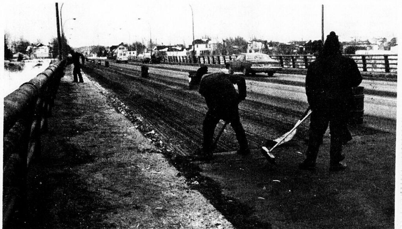
NETTOYAGE DU PONT — Des employés de la compagnie Sanivan sont à nettoyer le pont Nelson, à Jonquière, où un camion a déversé 3,000 gallons d'huile, après un spectaculaire plongeon. Des centaines de gallons d'huile ont déversé dans la rivière aux Sables et une
