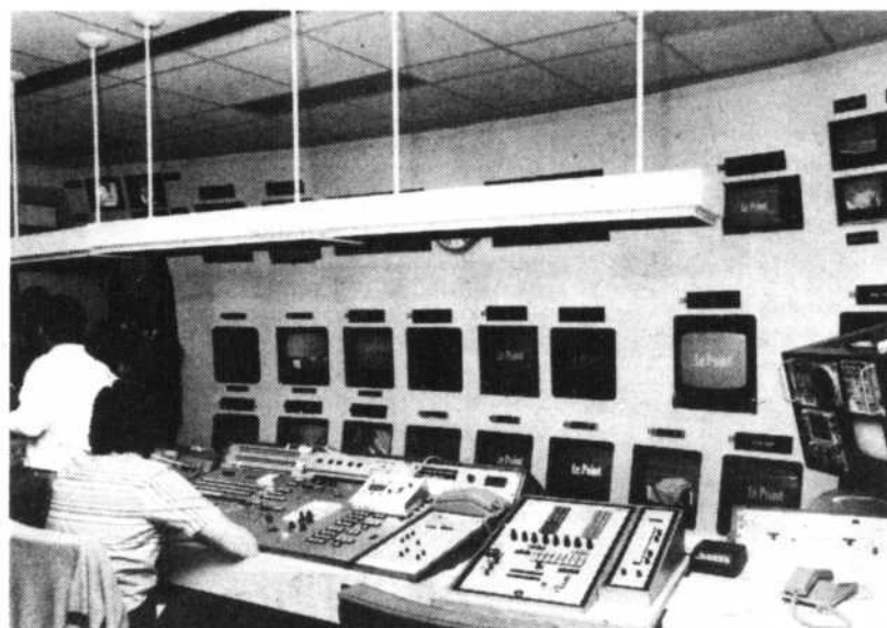
Toute la régie a été remaniée pour ajouter les nouveaux équipements et en faire un lieu fonctionnel et efficace.
