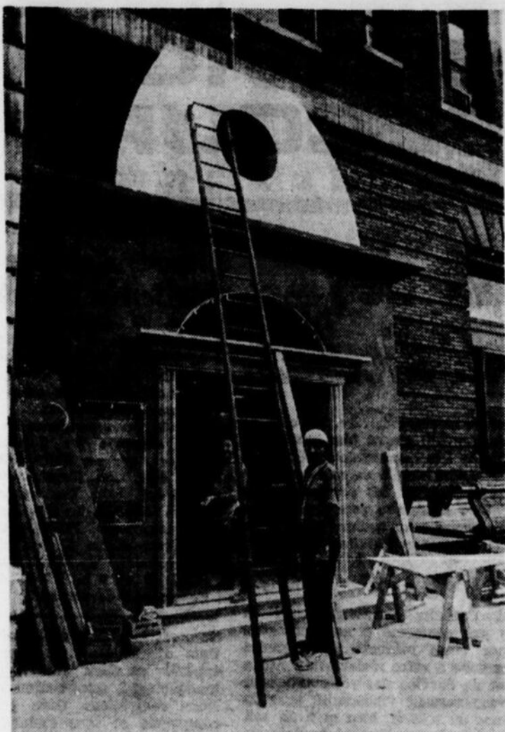
La porte d'entrée du Vaisseau d'Or, au 1100, rue Cypress, n'est pas tout à fait terminée. Le restaurant sera aménagé au sous-sol de l'hôtel Windsor. (Photo Gilles Corbeil)
