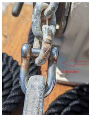
La manille ci-dessus risque de se rompre à tout moment, car nous ne pouvons déterminer à quelle profondeur se situe cette fissure de corrosion.
