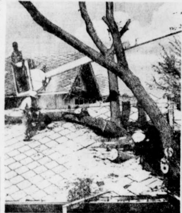
Avec l'aide de grues mécaniques, des hommes ont commencé hier à déblayer les arbres qui encombrant les maisons par suite du passage de "Betsy" sur la Nouvelle-Orléans.
